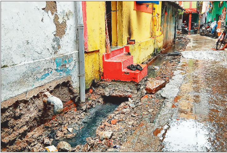
तेलीपारा दरबार लॉज के पीछे अधूरा निर्माण।
